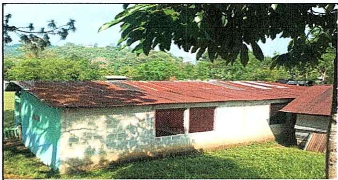
Foto 5: Aquí se muestra el deterioro de las láminas del segundo módulo en mal estado al igual la falta de repello.
