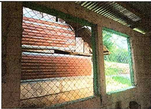
FOTO 5. Ventanales en mal estado, módulo 2.
