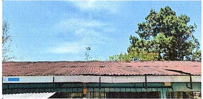
FOTO 2. En otro perspectiva en mal estado del modulo 1
