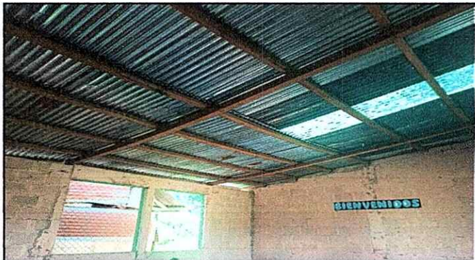
Foto 3: Aquí se muestra el deterioro de las láminas y vigas de madera de un módulo.
