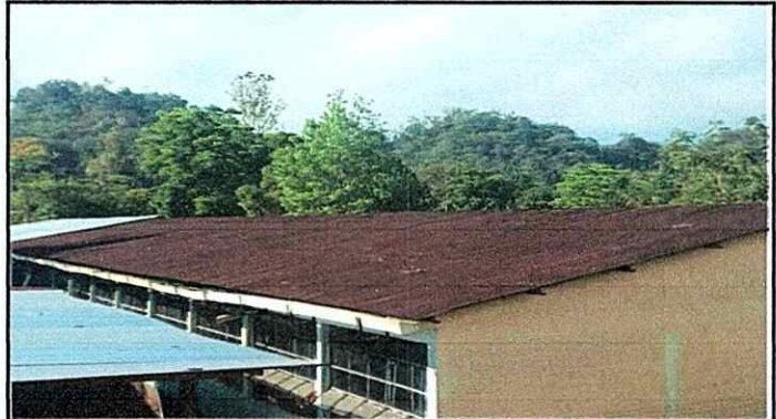
Foto 2: Aquí se muestra el mal estado de las láminas de tres módulos.
