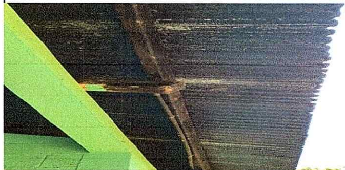
FOTO 4. Aquí se muestra el deterioro de la laminas del primer modulo.
