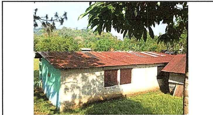
FOTO 3. Techo módulo 2 en mal estado
