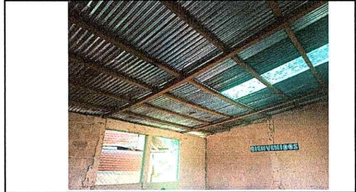
FOTO 2. Techo en mal estado, módulo 2.
