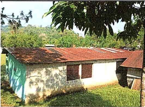
FOTO 3. Techo módulo 2 en mal estado
