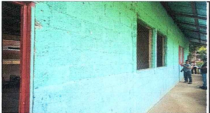
Foto 4: Aquí se muestra el estado de la pared de un módulo que necesita repello.
