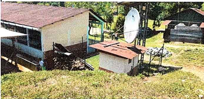
FOTO 5. Aulas en mal estado, se necesita pintar las paredes.
