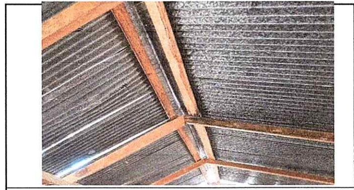
FOTO 6. Techo en mal estado, módulo 2.
