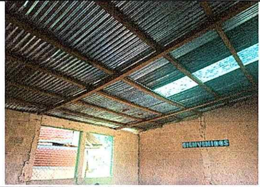
FOTO 2. Techo en mal estado, módulo 2.
