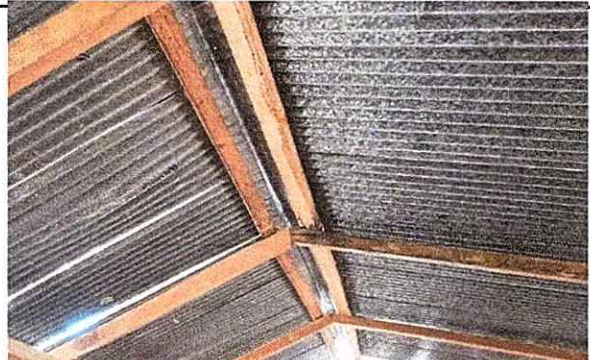
FOTO 6. Techo en mal estado, módulo 2.
