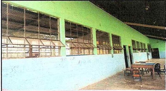
Foto 1: Aquí se muestra el estado de las paredes de tres módulos en la actualidad.
