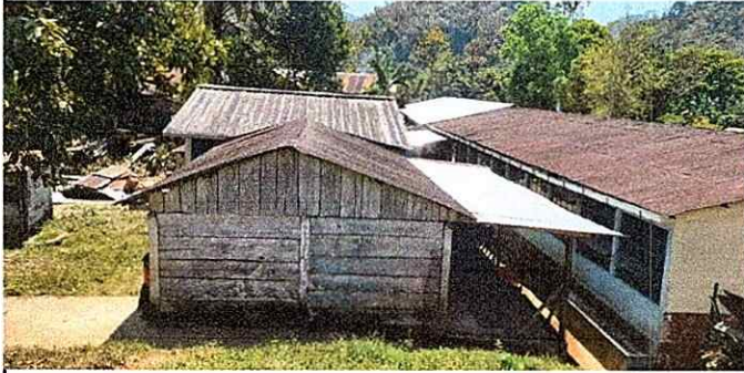
FOTO 1. Techo en mal estado .
