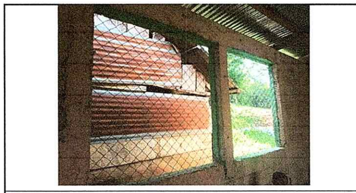
FOTO 5. Ventanales en mal estado, módulo 2.
